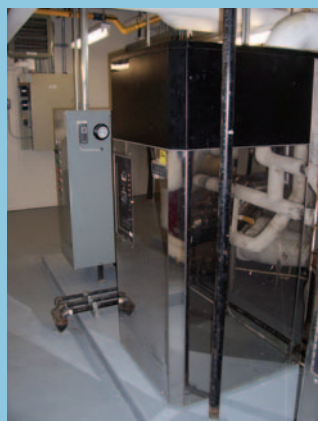
Chaudière à condensation (95% d'efficacité thermique)
